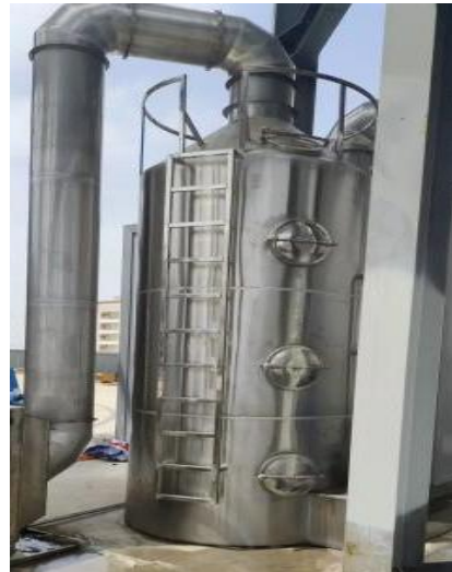
DA004 矿物油喷淋+干式过滤+两级活性炭处理装置
