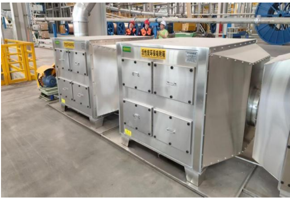
DA002 两级活性炭装置
