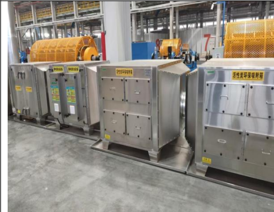
DA001 两级活性炭装置
