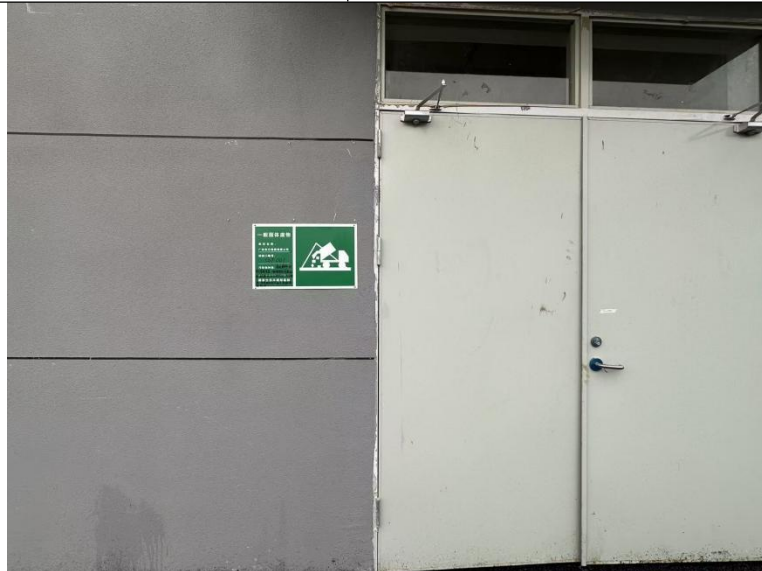
一般固体废物暂存间
