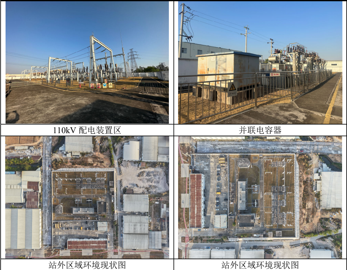
图 8 站内设施和站外区域环境现状图
