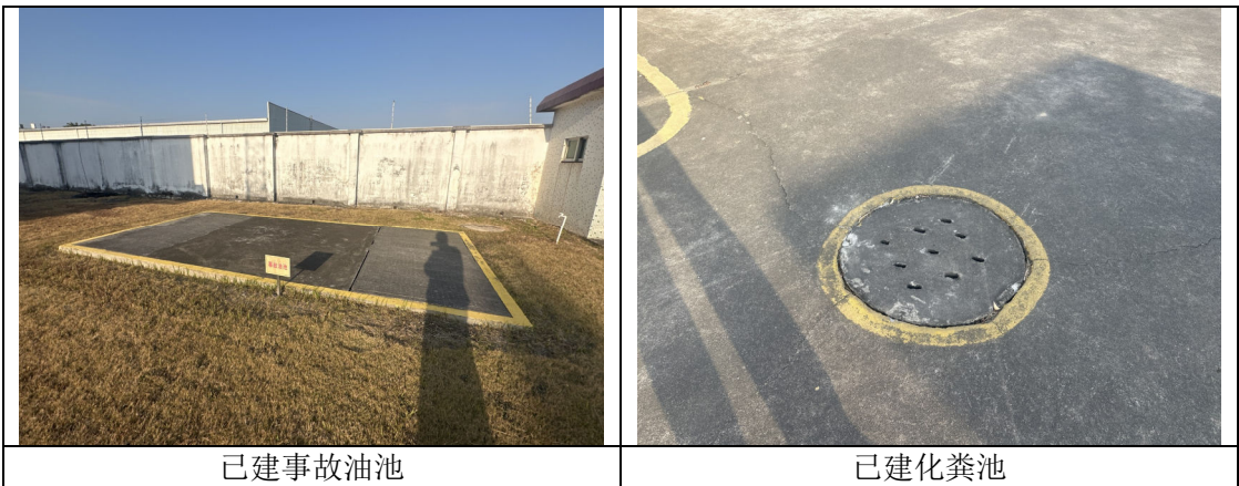
图 2 工程站内环保设施现状
