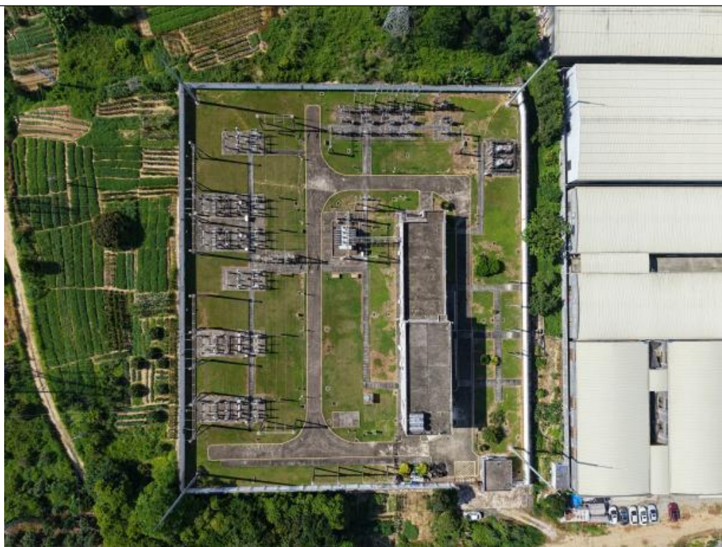
110kV 塘坪变电站
